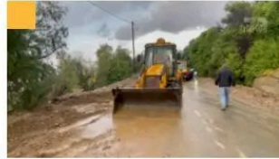
Top News – Moti i keq shkatërron Kretën. Makina në det, shtëpi të përmbytura dhe rrugë të dëmtuara
